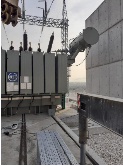
Şekil 35 : Temeline Sabitlenmiş Bir Trafo
