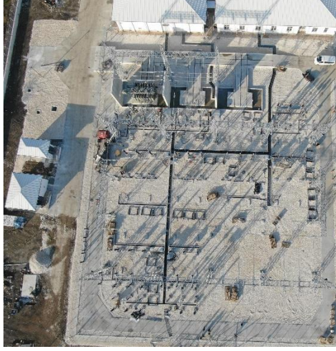
Şekil 38 : Yapımı Tamamlanmış Bir Trafo Merkezi
