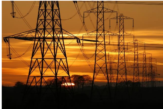
Şekil 41 : 380 kV İletim Hattı
