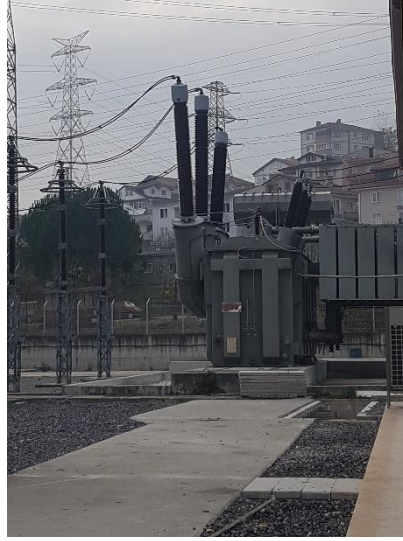
Şekil 10 : 380 kV/ 154 kV Ototrafo ve Parafudr
