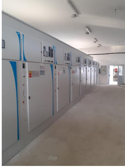
Şekil 36 : Kapalı Şalt Binası ve Teçhizatları
