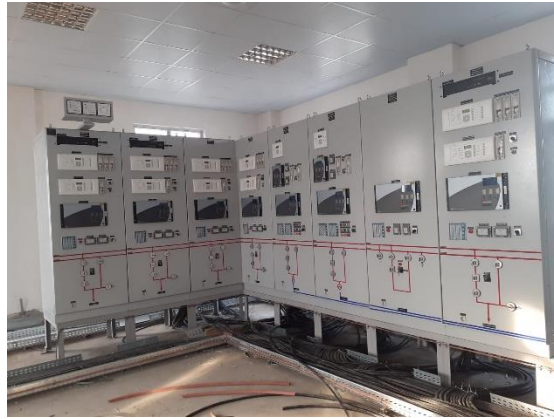
Şekil 37 : Kumanda Binası ve Teçhizatları
