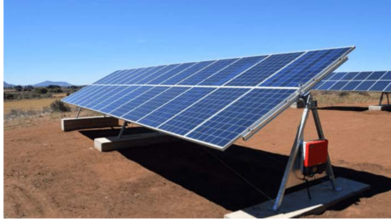
Şekil 15. Güneş takipli solar panel
